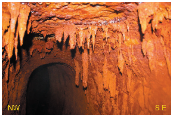
Rys. 4. Znaczna koncentracja nacieków w strefie intensywnego dopływu wód szczelinowych, formy nacieków świadczą o wielokrotnym ich narastaniu i ługowaniu, w zależności od poziomu zwierciadła wody w wyrobisku
