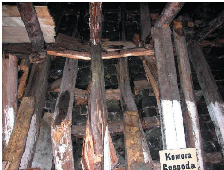
Rys. 3. Widok na południowy ocios komory, widoczny wypchnięty do wyrobiska mur solny i połamane stojaki (Parchanowicz i in., 2009)
