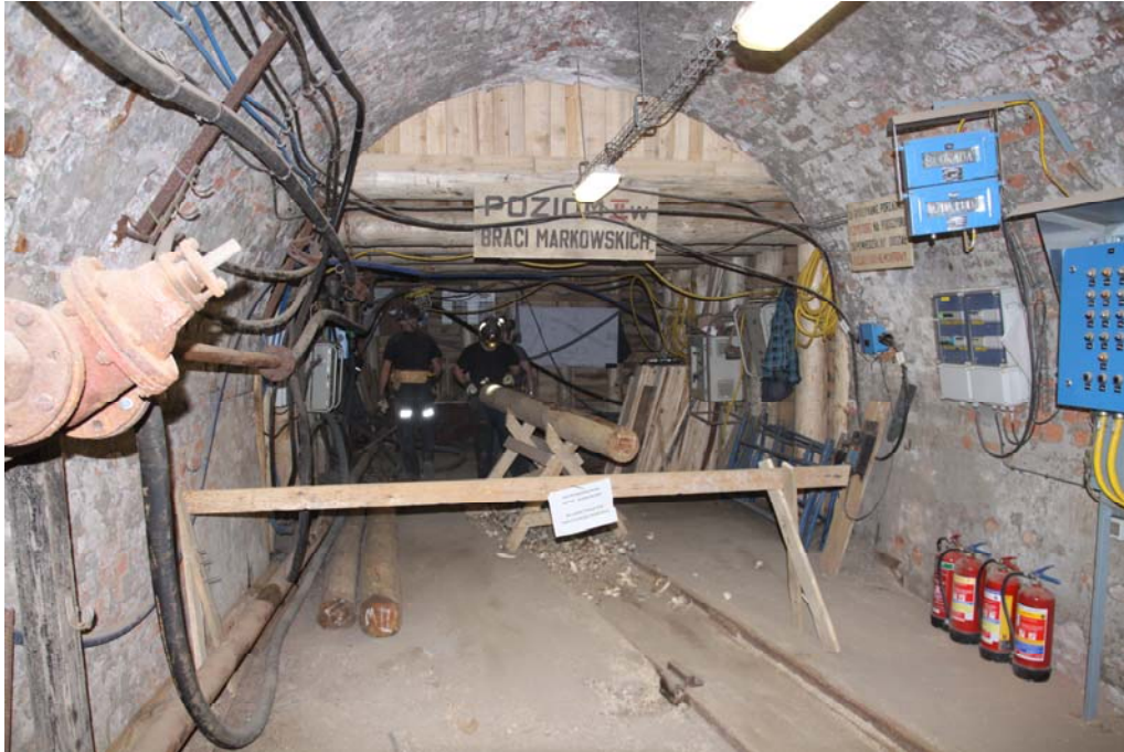
Rys. 7. Podszybie szybu Kinga na poz. II w. po modernizacji sygnalizacji Fig. 7. The King's shaft bottom after signaling system work. Level II
