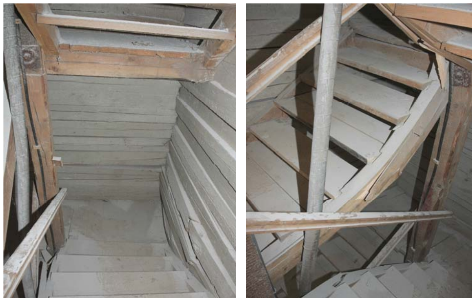
Rys. 4 i 5. Zniszczona konstrukcja schodów i obudowy szybika
